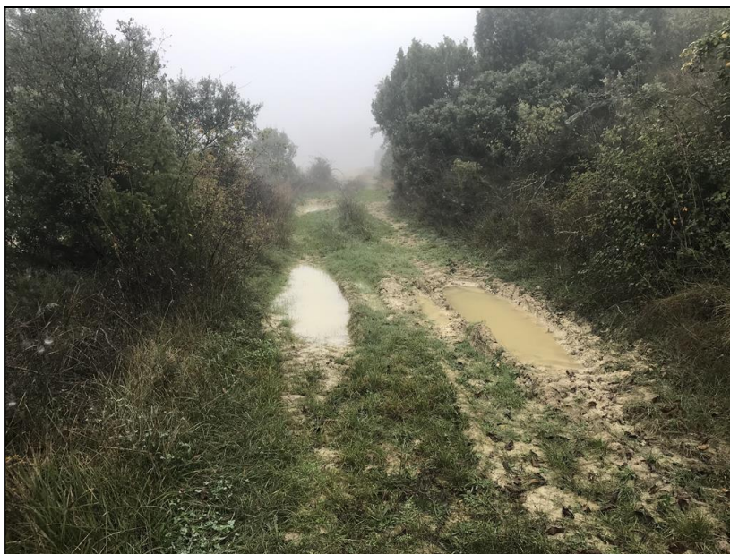
Imagen 13. Acumulación de agua en el camino a la altura del p.k 0+850
