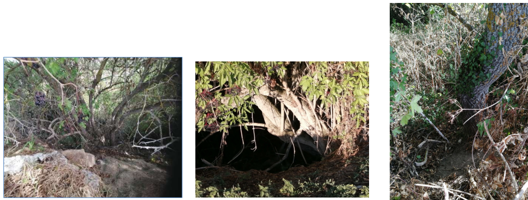
Figura 8. Vegetación desarrollada sobre el talud sur, que realiza funciones que son clave para evitar su desmoronamiento
